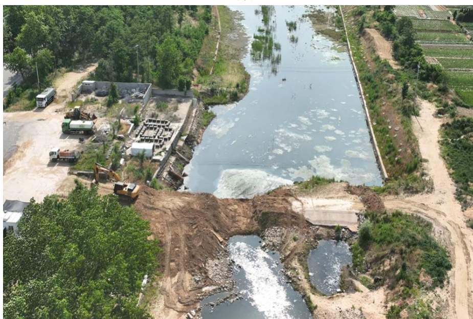
图 2-18 2024 年此处河道较窄阻塞河道清除土坡（经调查为施工便道，目前已清理）
