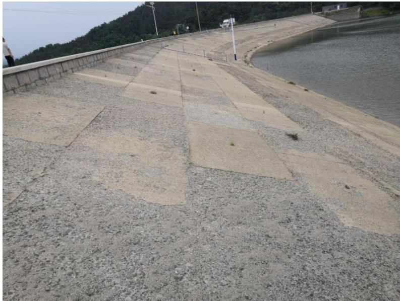
图 2-10 2021 年大坝迎水坡混凝土老化、脱皮（2022 年完成了除险加固，问题已整治）
