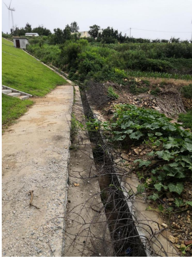
图 2-13 2021 年排水沟存在树枝（现已整改完成）
