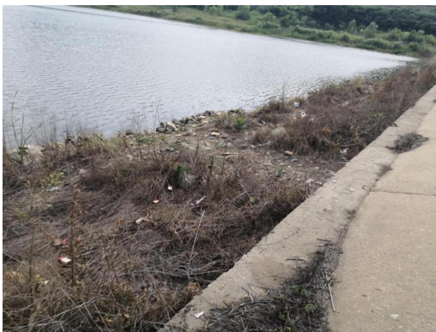
图 2-1 2021 大坝迎水坡齿处有白色垃圾（已于当年完成清理）
