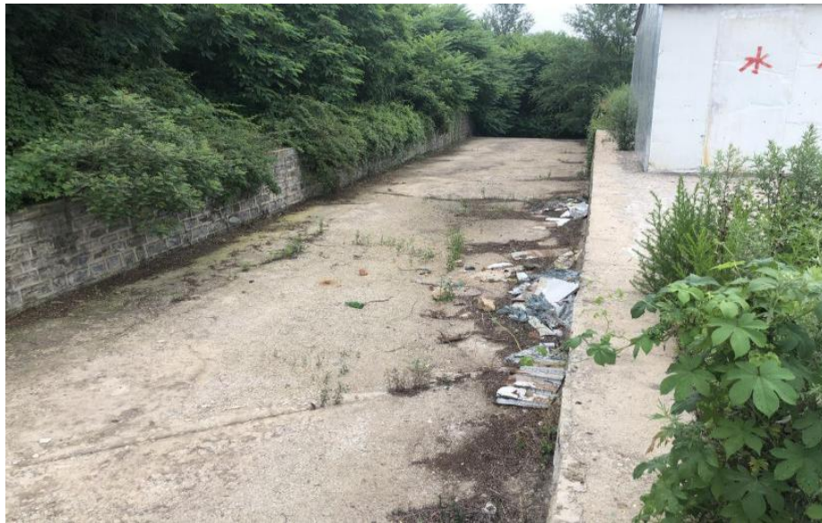
图 2-4 2021 年水库溢洪道垃圾较多（已于当年完成清理）
