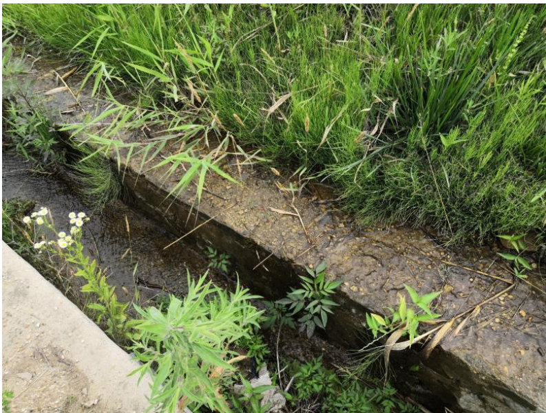
图 2-11 2021 年大坝背水坡渗漏水（2022 年完成了除险加固，问题已整治）
