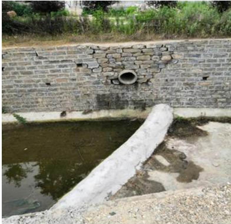
图 2-12 2021 年溢洪道部分挡墙损坏（现已修复）
